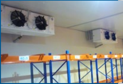
▲ Acht verschieden groß dimensionierte Güntner Luftkühler CUBIC Vario AGHN und Direktverdampfer verteilen die Kälte gleichmäßig in den Lagerräumen.
