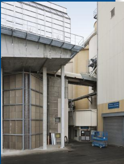
Zehn Güntner Luftherhitzeblöcke des Typs GCO (auf dem Bild noch ohne Verkleidung) erzeugen Warmluft für die Darre.
